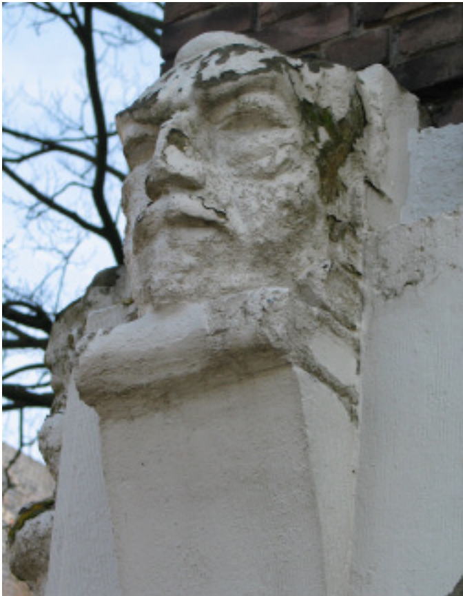
4 Schade aan het portret van Wibaut.
